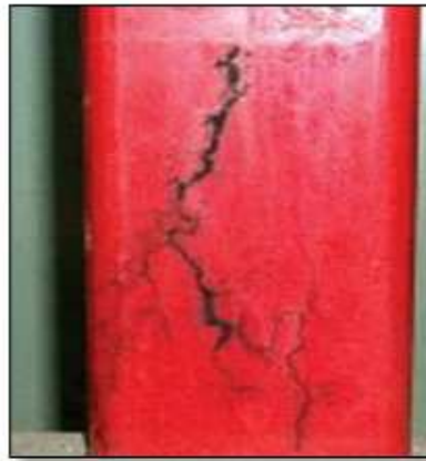
Электрическое отслеживание шины высокого напряжения из-за загрязнения
