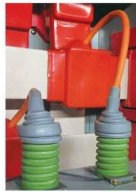
Установленные емкостные датчики
